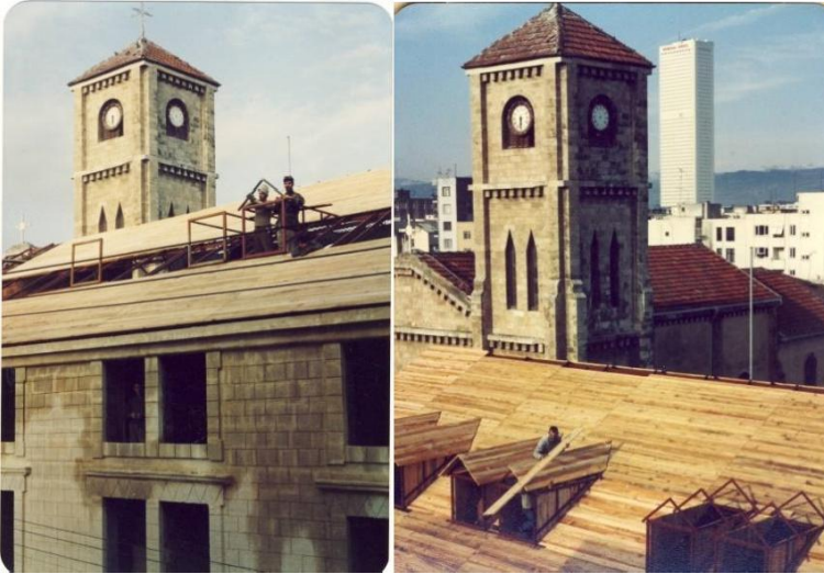
Resim 8. Yapının 1990-93 Yılları Arasındaki Restorasyonu Sırasında Çatı Kaplaması ve Çatı Pencerelerinin Yapılışı (Hanri Leylek Arşivi)
