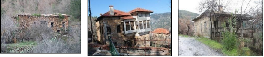
Resim 4. İspatlı Köyü (solda), Türkteş Köyü (otada) ve Uğurlu Köyü'nde (sağda) terkedilmiş ve yıkılmaya yüz tutmuş yapılar. Ortadaki yapı sadece yazın kullanıldığından daha iyi durumdadır.
