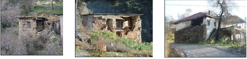
Resim 6. Bayırkozağacı Köyü (solda), Burçaklar Köyü (ortada) ve Güney Köyü'nde (sağda) büyük oranda veya kısmen yıkılmış yapılar.
