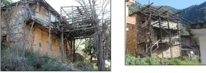
Resim 5. Asmaca Köyü (solda) ve Gümüşgöze Köyü'nde (sağda) deforme olmuş ahşap elemanlar.
