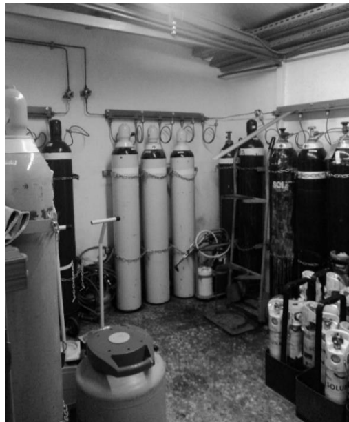
Şekil 1: Potansiyel yangın tehlikesi içeren bir tıbbi gaz depolama alanı.
