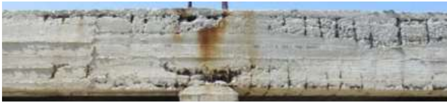
Şekil 3. Betonarme Kirişlerde yetersiz beton örtüsü sonucu oluşan durum.
