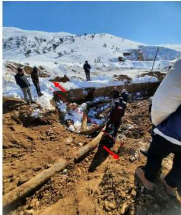
Şekil 3. Çelikhán-Adıyaman yolu üzerinde su borusunda gözlenen 3 metre sol yanál ötelenme
