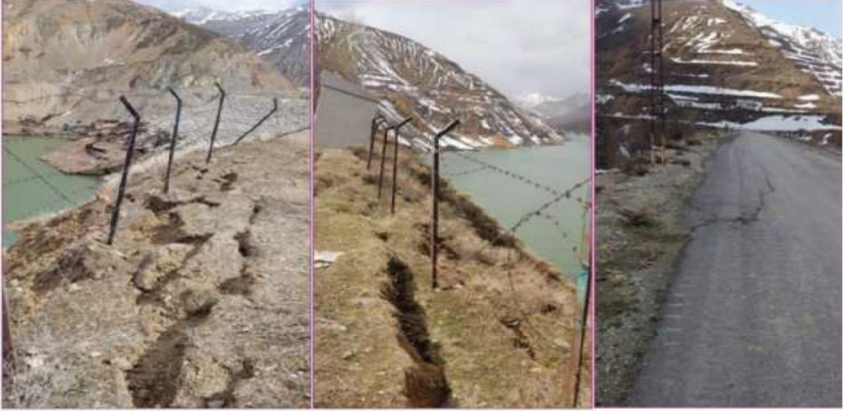
Şekil 1. Çat Barajı kretinde kayma yüzeyi boyunca gözlenen hareketler
